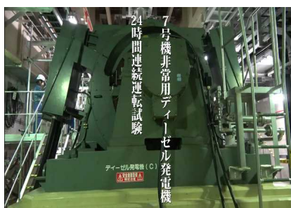
『非常用ディーゼル発電機24時間運転試験』
