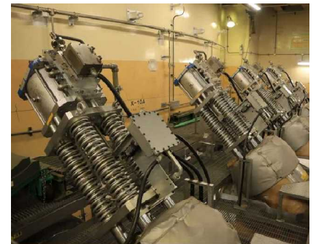
確認する弁の例 主蒸気隔離弁
