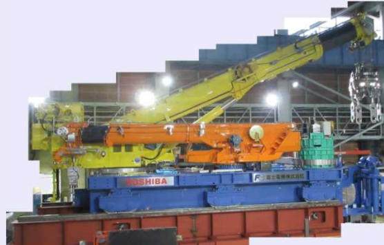
<燃料取扱設備>
