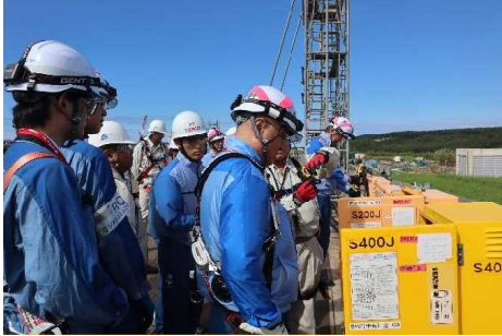
屋外仮設分電盤のパトロールの様子
